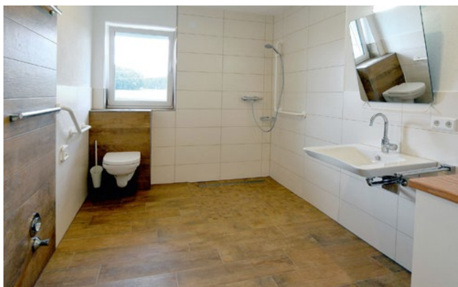
Die modern eingerichteten Ferienwohnungen wurden mit zukunftsweisender Wärme- und Warmwasserversorgung ausgestattet
