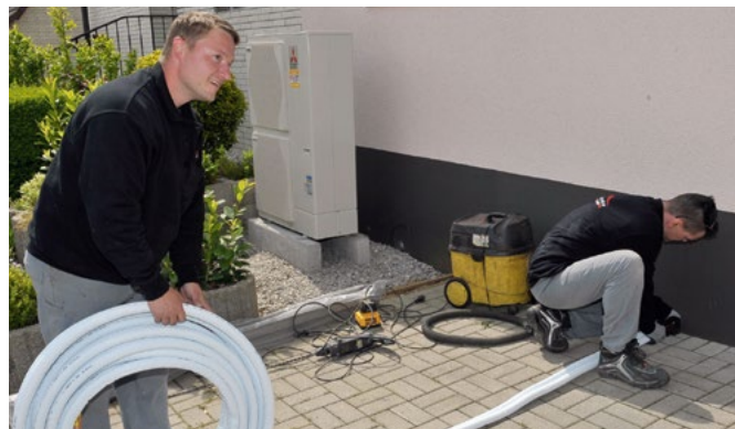
Für die Verbindung der Wärmepumpenmodule wird nur ein kleiner Wanddurchbruch benötigt
