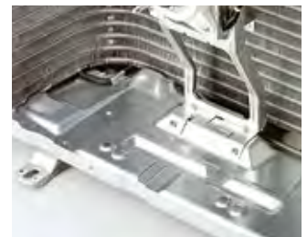
Gleicher Betriebszustand am Außengerät mit integrierter Wannenheizung
