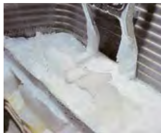
Eisbildung am Außengerät ohne Wannenheizung
